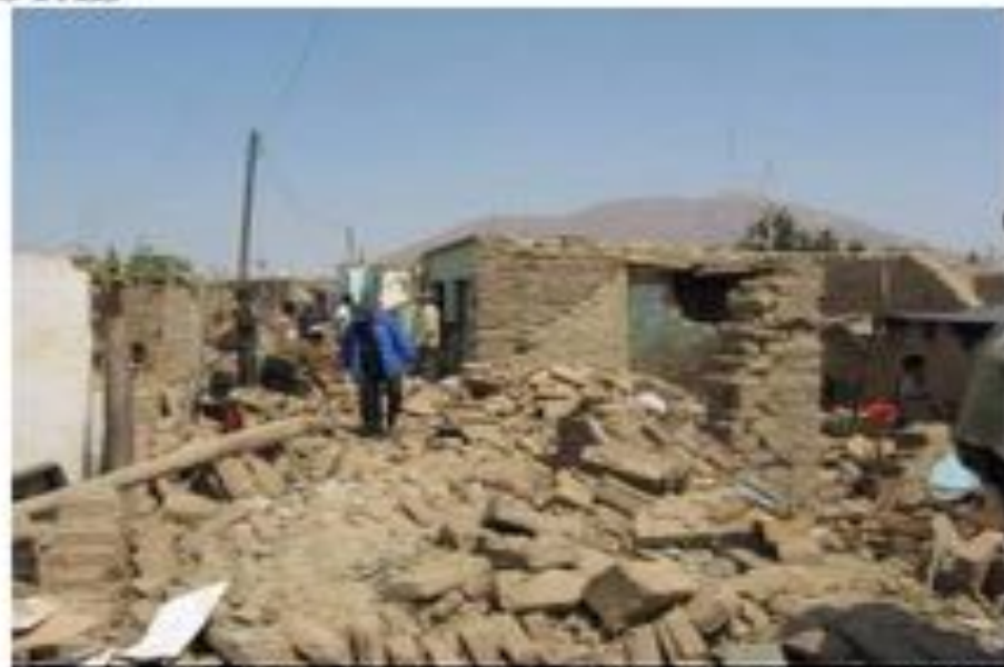
Foto 10. Colapso total de vivienda de adobe. Manayara 2001. Foto CID.
