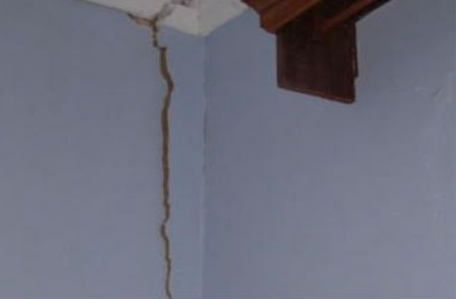
Fig. 1. Grietas verticales en muros interiores. 2007. Foto D. Torrealva.
